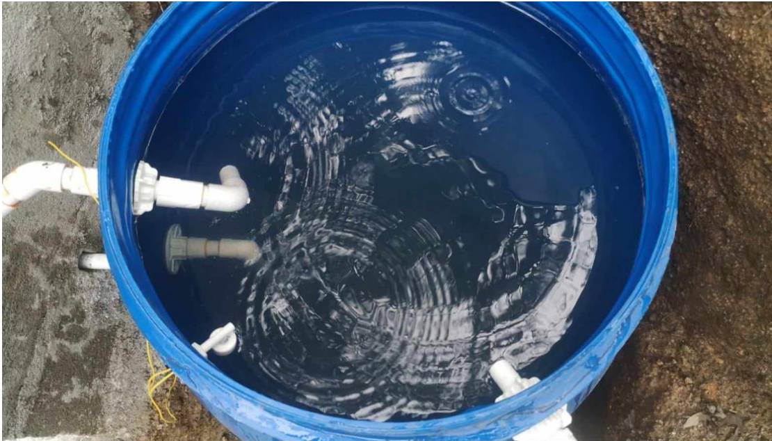
Tanque de cloración
