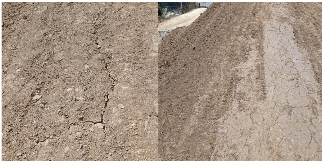
Fallas presentes en el suelo
