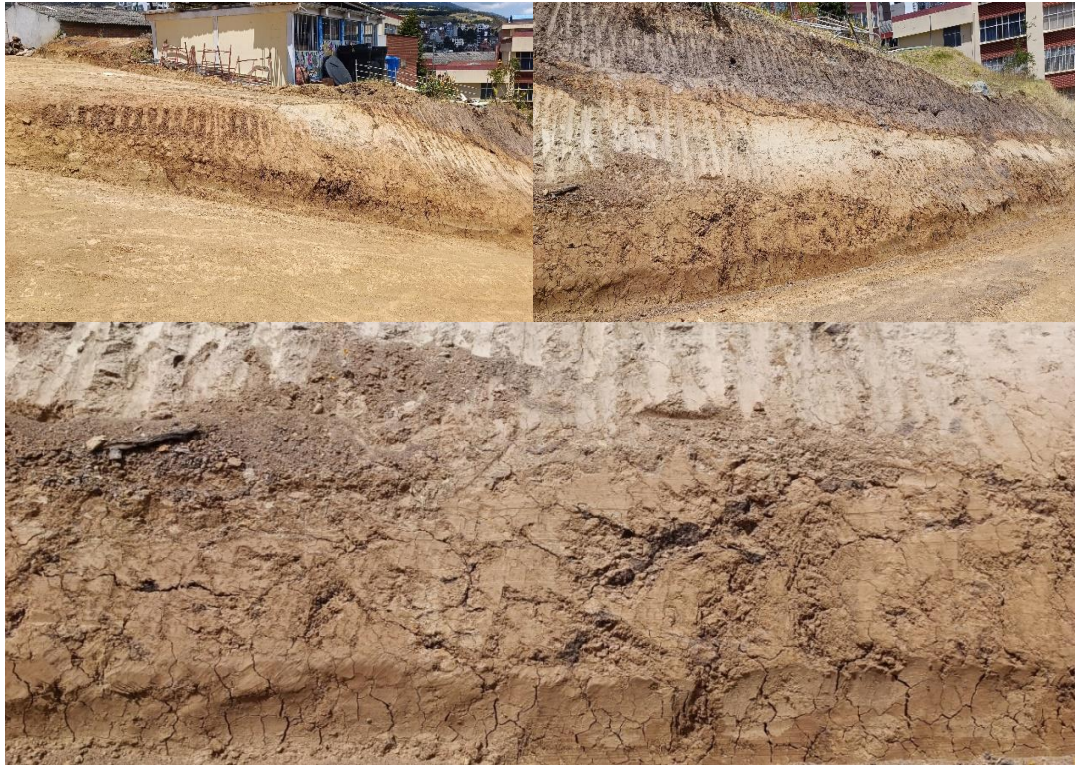
Grietas presentes en el talud
